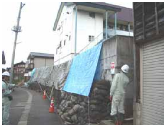
写真-2 宅地擁壁の被災度判定状況（十日町市）
