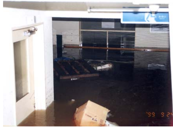
写真-1 場内冠水の様子 (周南流域下水道浄化センター提供)
