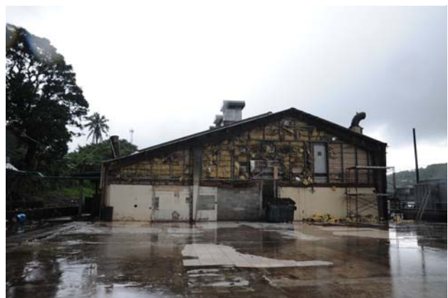
写真-3 津波被害を受けた Satala 発電所
