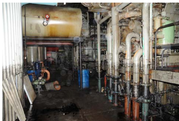
写真-4 津波を受けた Satala 発電所の内部
