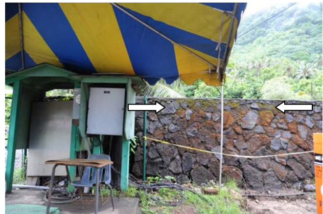
写真-7 津波による擁壁のコーキングの変色 (Korea lift station)
