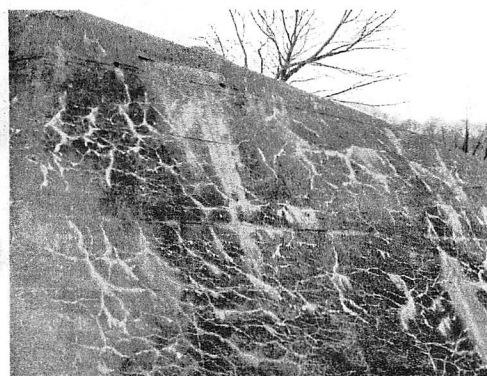
写真 2 ASR が発生した構造物
