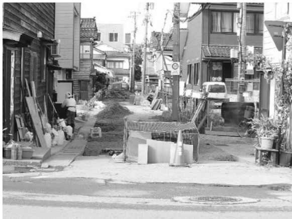
図7 輪島市の水害後の様子
