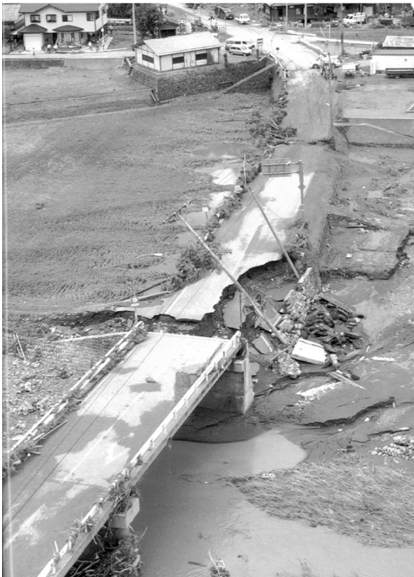
図5 高田大橋周辺被害状況（2004年7月19日福井新聞社撮影）。
