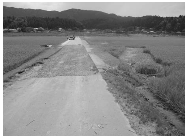
(b) 堤内地の農道舗装の剥離（著者撮影）
