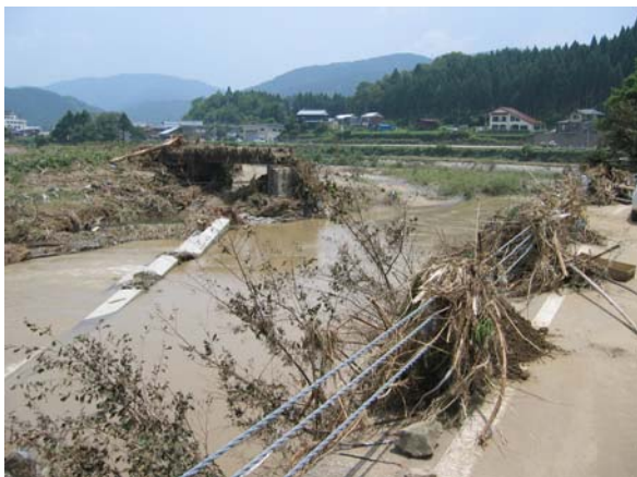
図-4 田尻新橋の被害状況（2004年7月22日，著者撮影）
