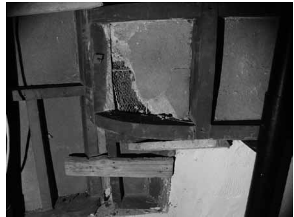
図 13 主祭壇の裏側 モルタルが大きく剥落し金網が露出している
