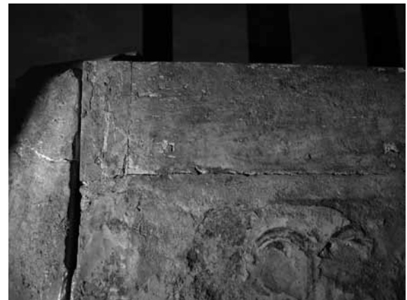
図 14 柱の北側の壁画 モルタルに壁画と木材の境目で亀裂が生じている
