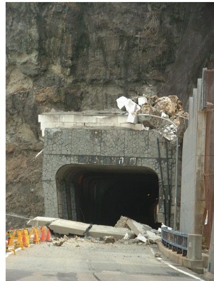
写真-2 落石により損傷した八世乃洞門
