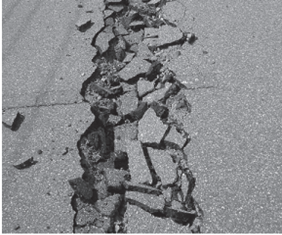
写真1 アスファルトのひび割れ
