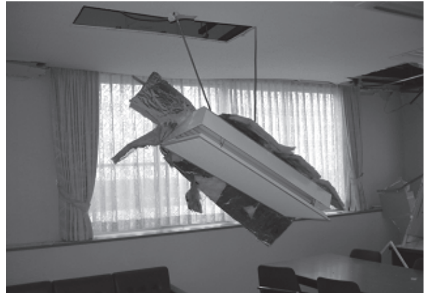
写真4 天井式エアコンの脱落
