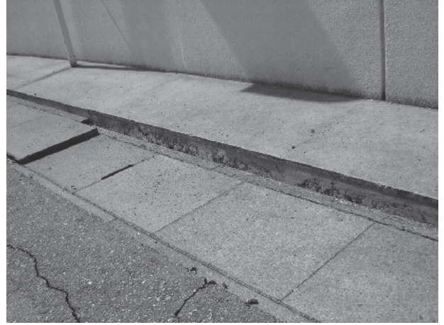
写真2 工場建屋外周にできた段差
