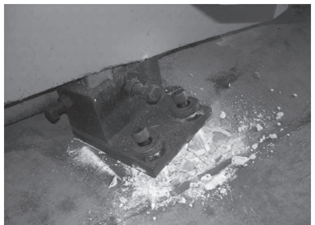
写真6 破損したアンカーボルト
