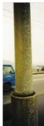
図10. 重慶大橋のコンクリート電柱の腐食 （製鉄所がある方向だけに骨材が露出）
