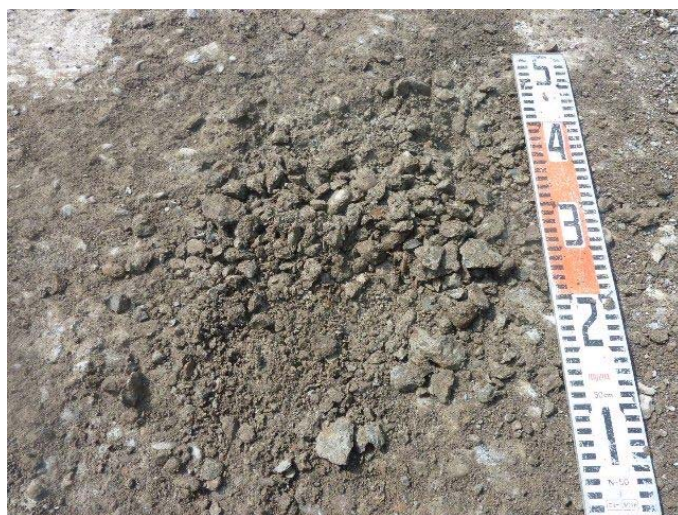
写真-6.4.1 劣化床版上縁の砂利化
