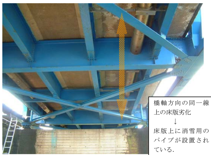
写真-6.1.1 温度負荷を受ける床版劣化の例
