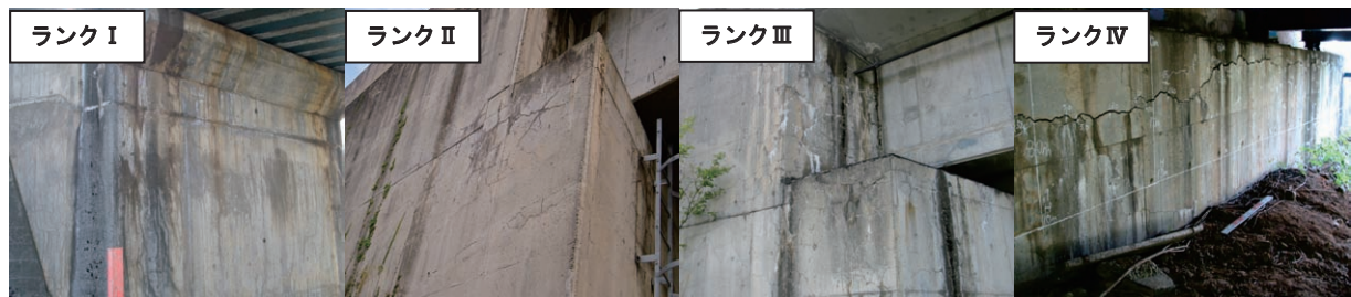
写真-6 ASR劣化構造物（橋台）のひび割れによる劣化度ランクの一例
