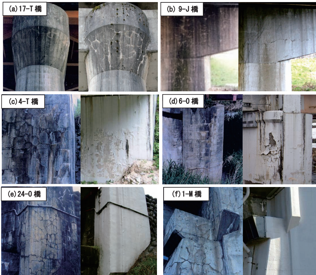
写真-2 ASR 劣化橋梁の外観の比較 (左側: H2 年度, 右側: H18 年度)
