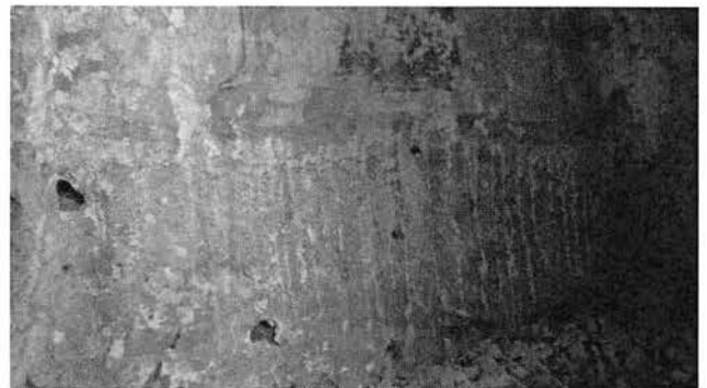
Fig. 29 消石灰水が流れた痕跡
