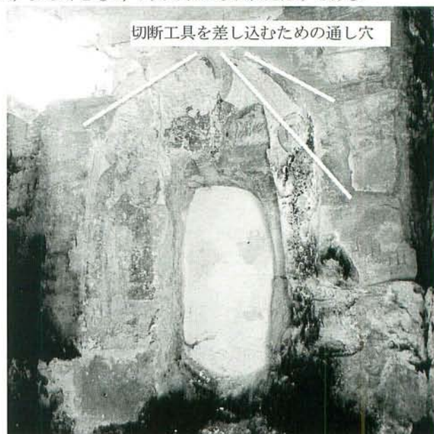
Fig.9 損傷がひどい後陣壁
