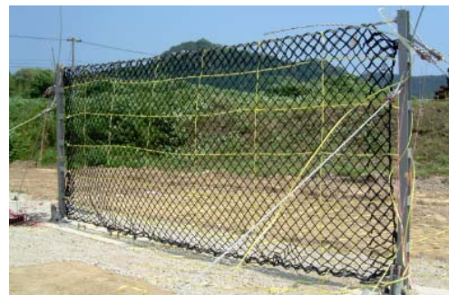
写真1 ポリエチレンネット製落石防護柵
