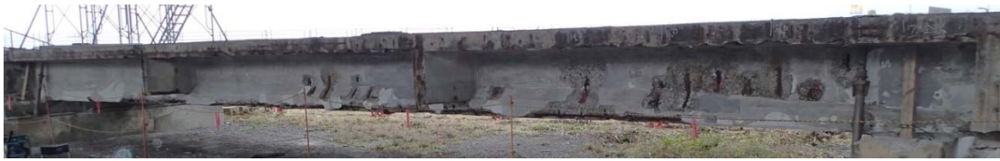
写真 3.1 撤去した PCT 桁の試験体の劣化状況
