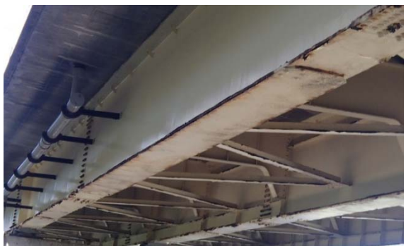
(d) 鋼橋の塩害による塗膜劣化および腐食状況
