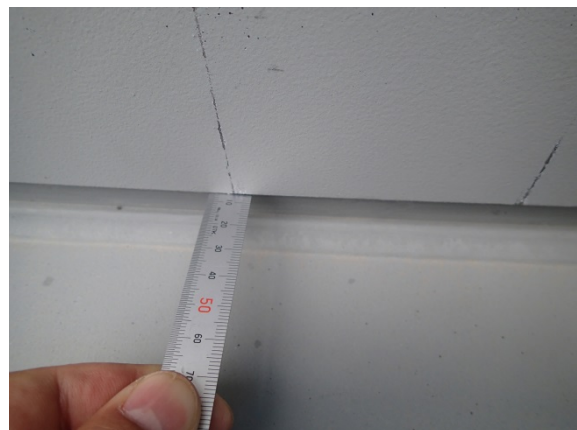
(f) 腐食損傷部の拡大(減肉量 6mm, 板厚 3mm)
