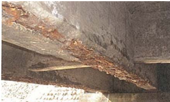
(a) RC 桁橋の塩害による損傷
