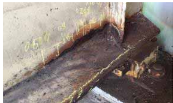
(b) ウェブ支間側の腐食損傷事例
