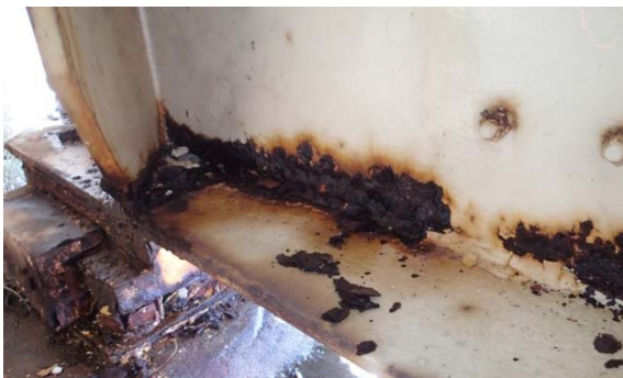
(e) 鋼橋桁端部の腐食状況
