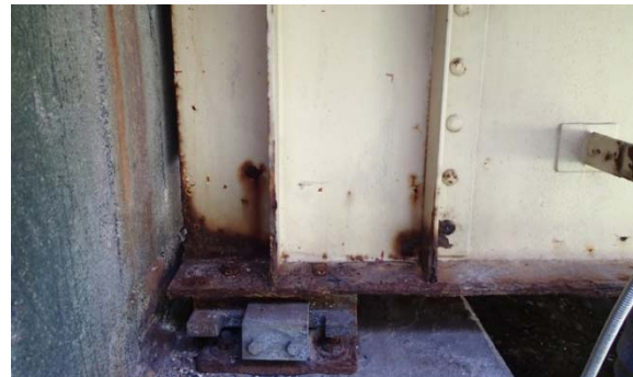
(d) 鋼橋桁端部の腐食状況
