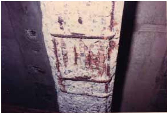
(c) シース管の腐食状況 (1982.11)
