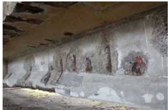
(g) 主桁側面の損傷状況 (2014.10)
