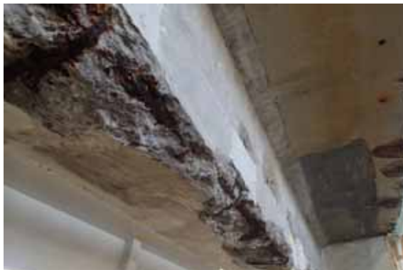
(f) 主桁下面の損傷状況 (2014.10)
