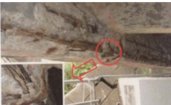
(c) 塩害劣化した PC 桁と PC 鋼線の腐食
