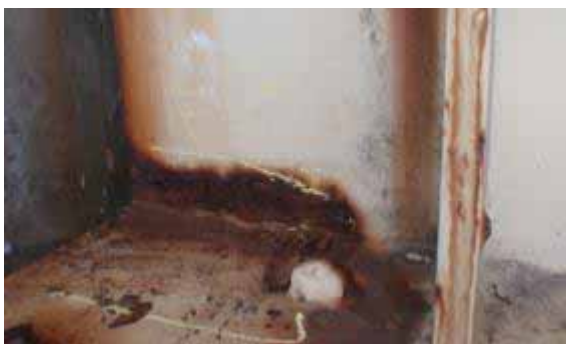
(a) ウェブ桁端側の腐食損傷事例
