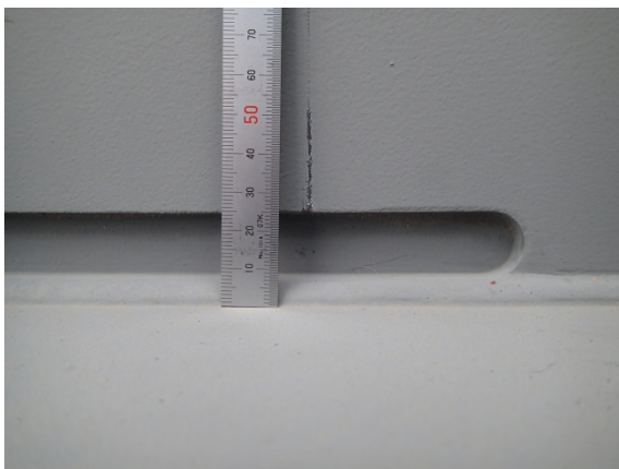
(e) 腐食損傷部の拡大 (腐食高 25mm)
