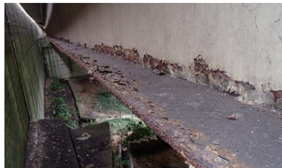
(f) 鋼橋の中分側の下フランジの局部腐食状況
