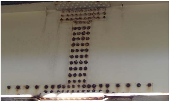
(f) 添接部における腐食状況
