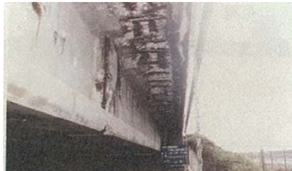
(b) PC 桁橋の塩害による損傷
