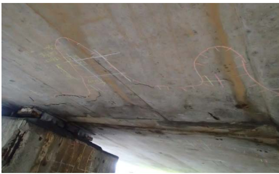
(a) 凍結防止剤による桁端部の塩害事例
