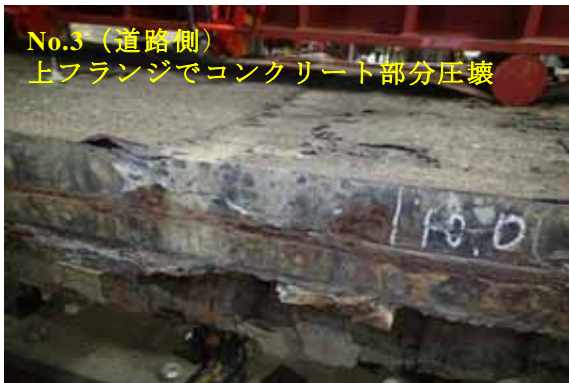
(c) No.3 上フランジの損傷状況
