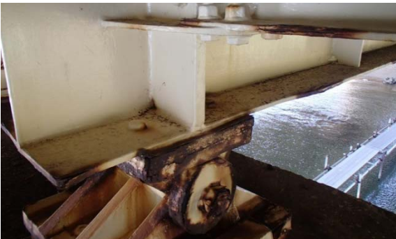
(e) 鋼橋桁端部および支承部の腐食状況
