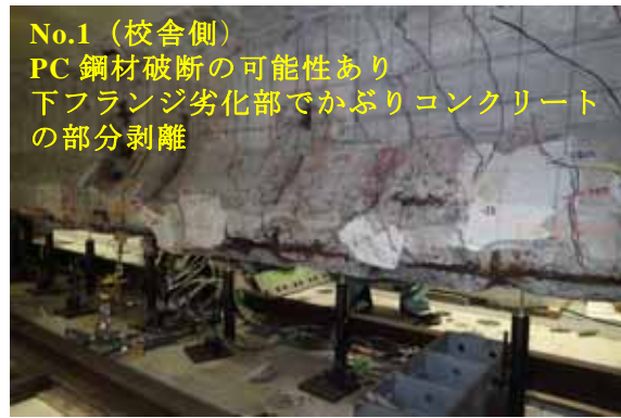
(b) No.1 主桁側面の損傷状況
