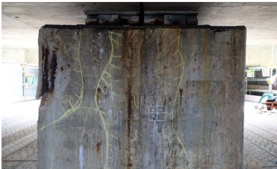
(c) 掛け違い橋脚部の浮き損傷の状況
