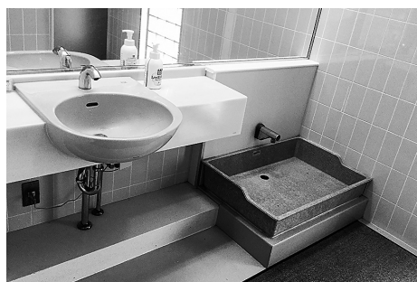
写真1 トイレ内に設けられた足洗い場
