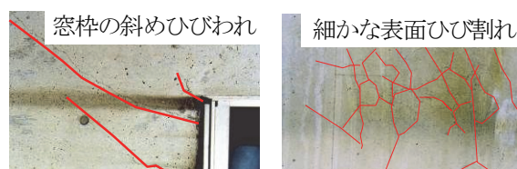
図-12 乾燥収縮の特徴（ひび割れ形状の違い）
