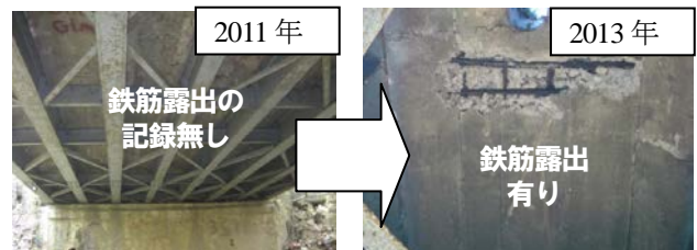
新たな損傷の確認 (鋼橋の床版) の例
