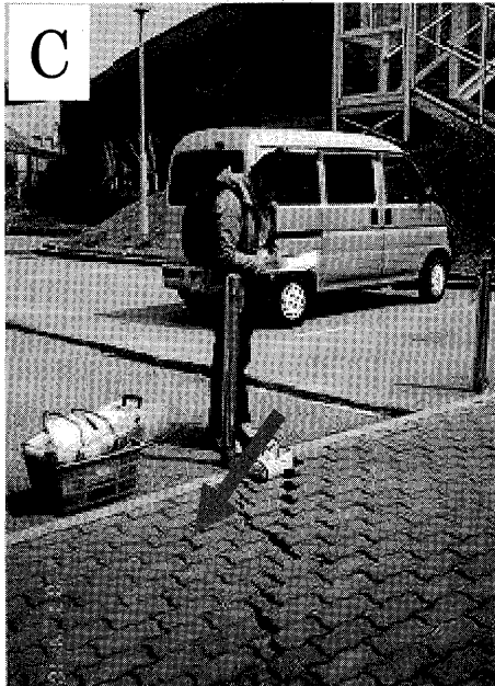
2007.4.10.12:49 門前町じんのびの湯 入口歩道亀裂(矢印) 80 – 90 cpm
