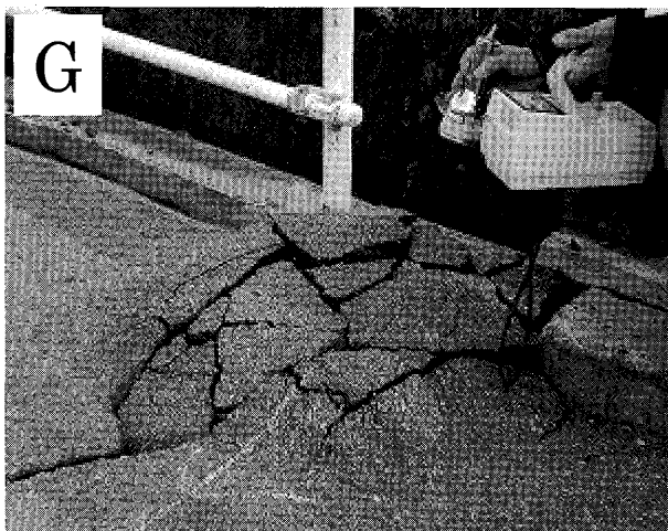
輪島市門前町道下 2007.4.8.16:53 80 - 90 cpm 道路コンクリート隆起
