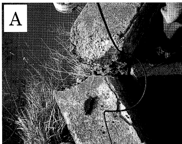
A 輪島市門前町道下 2007.4.8.15:57 100 - 120 cpm 道路わきの亀裂
