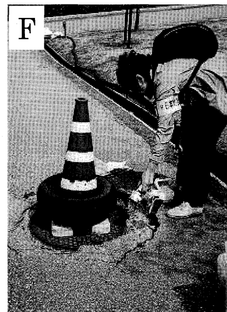
2007.4.10.12:59 門前町じんのびの湯 マンホール陥没 90 – 100 cpm
