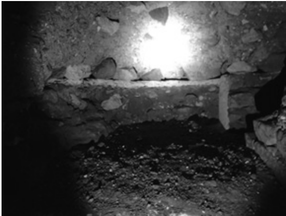
Fotografía 3. Túnel del Templo 11 sin consolidación, posiblemente huella del colapso
