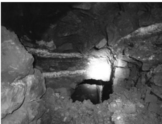
Fotografía 5. Estado del colapso del túnel I-27 en Septiembre de 2017.
