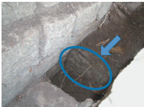
Foto 15: Evidencia del anexo este en la Etapa II que apareció a la izquierda (en el lado interior) del muro de contención este de la Foto 14
