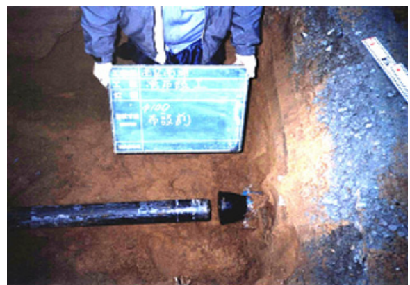
写真-2 継手部離脱状況
