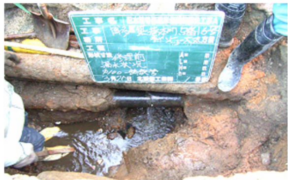
写真-1 折損状況
