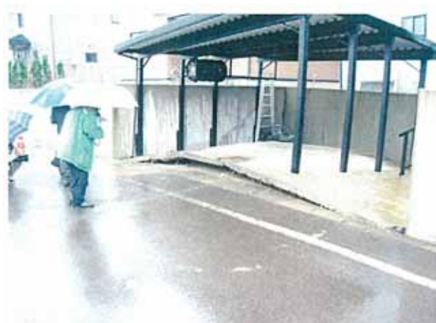
写真-1 液状化による駐車場の隆起現象
