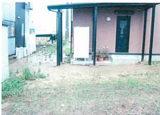
写真-2 液状化による噴砂現象
