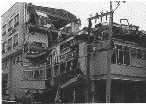
写真-2 独立柱化した細長い柱が座屈した建物(提供:E.Rodriguez grandos)
