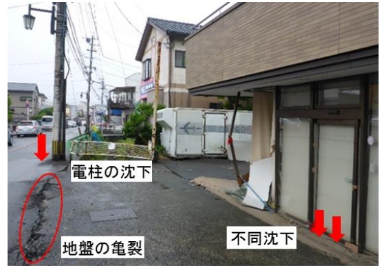
写真-1 液状化による地盤沈下
