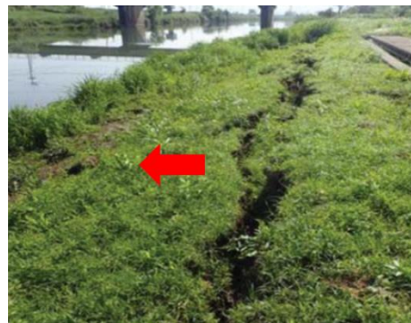
写真-3 護岸の側方流動
