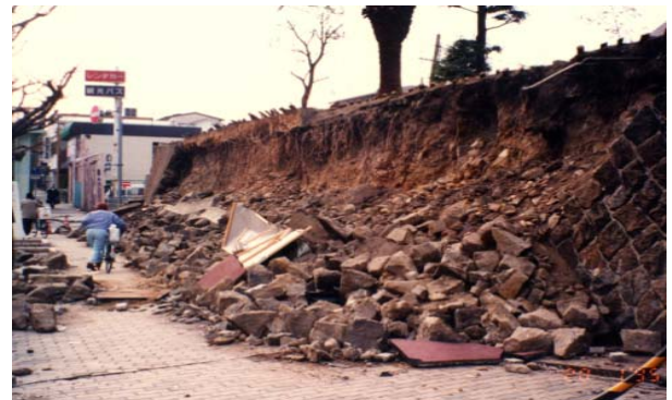
写真-1 擁壁被害
