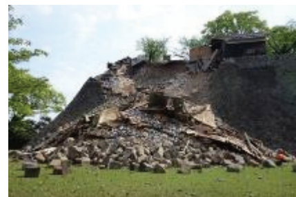
写真-1 熊本城重要文化財「北十八間櫓」石垣の崩壊状況
