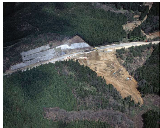
写真-1 能登有料道路における盛土の被災 4) (縦-38での例)
