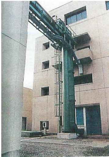
写真-3 汚泥パイプ輸送設備の一部
