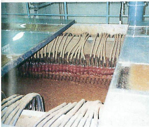
写真-4 汚泥改質機
