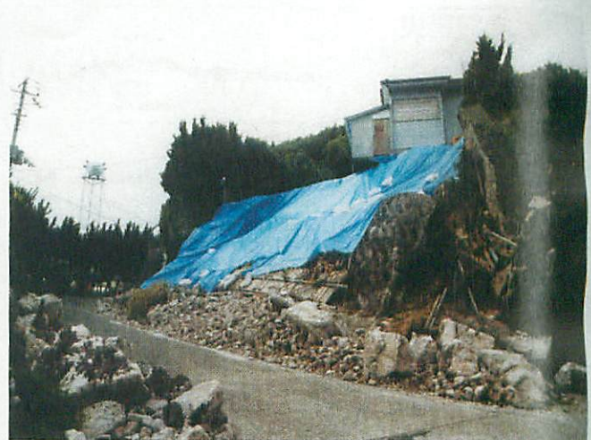
写真-3 石積擁壁の崩壊
