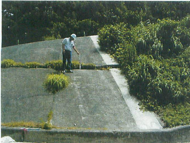
写真-2 上下道路の中間斜面の亀裂
