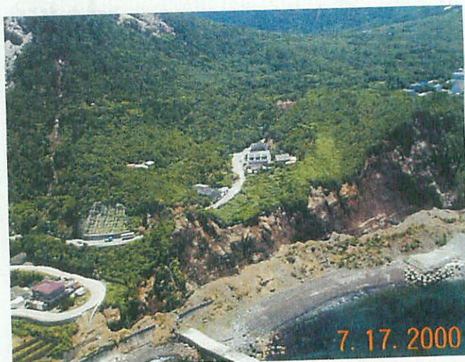
写真4 新島若郷地区の斜面崩壊現場
