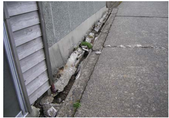
写真-8 建物基礎部コンクリートの破壊
