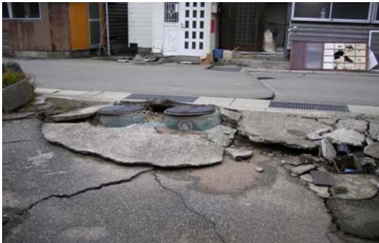
写真-3 液状化による合併浄化層の隆起 (Bv-1付近)
