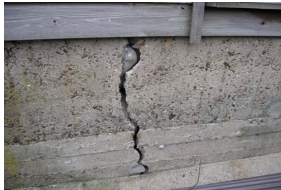
写真-11 建物基礎の縦クラック
