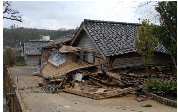
写真-7 液状化による噴砂現象が生じた建物の倒壊 (Bv-2 地点付近)
