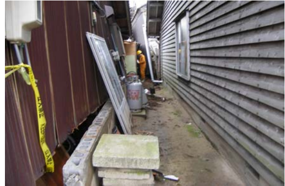
写真-9 コンクリートブロック基礎の崩壊
