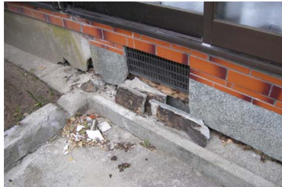
基礎の部分の木材が腐っている 写真-10 建物基礎の崩壊
