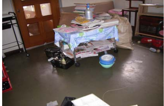
写真-4 建物床部分の隆起 (Bv-1付近)
