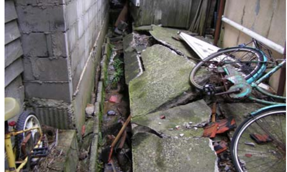
写真-6 液状化による宅地地盤の隆起 (Bv-1付近)
