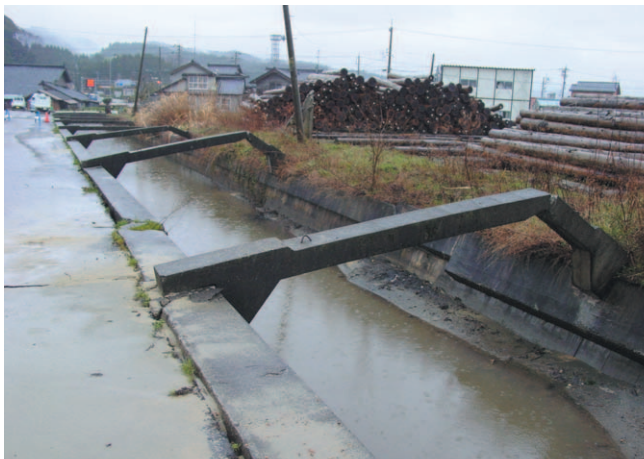
写真-3 液状化地盤の側方流動により水路幅が約 40cm 減少する (七尾市大田町)
