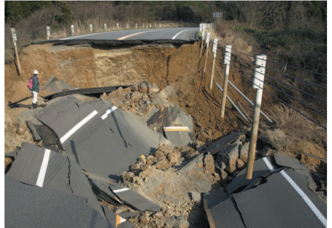
写真-4 能登有料道路 6.3km 地点の盛土崩落
