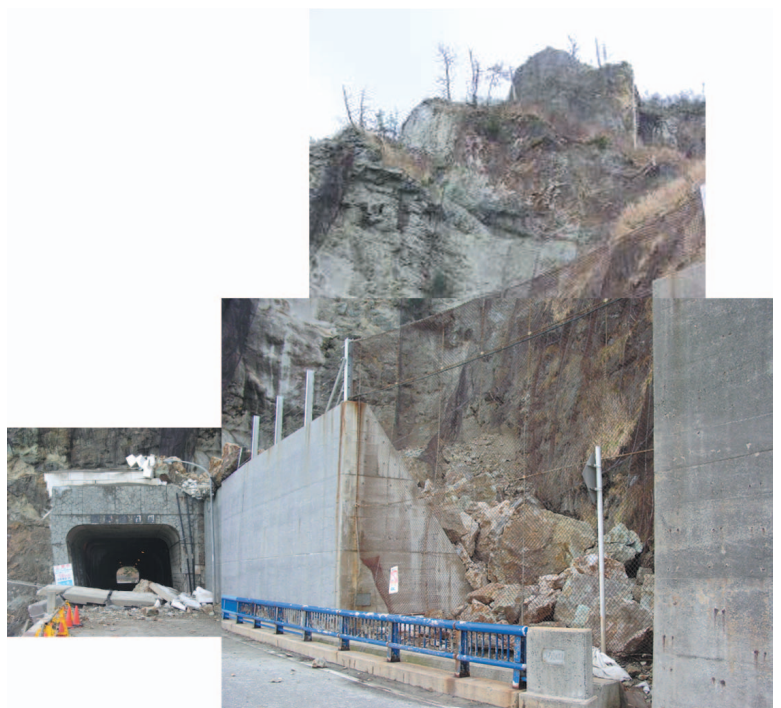
写真-1 八世之洞門入り口における落石被害 (輪島市町野町)
