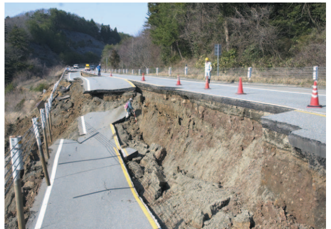
写真-5 能登有料道路 11.7km 地点の盛土崩落
