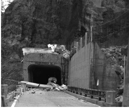
写真5 落石により破壊したロックシェッド (石川県)
