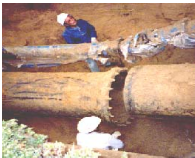
写真-1 ダクティル鑄鉄管のK形継手抜け出し状況 (神戸市水道局 提供)
