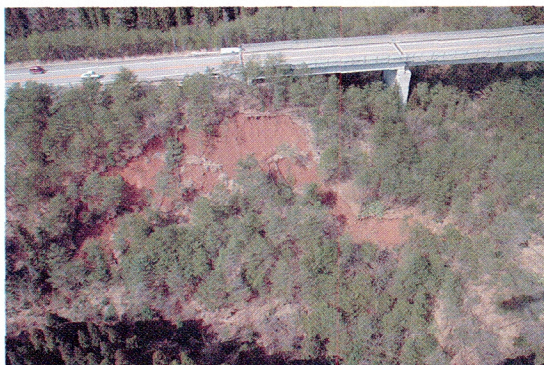
写真-1 能登有料道路の被災状況
