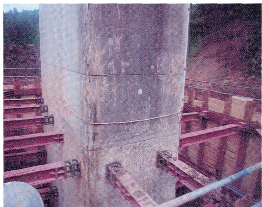
写真-10 橋脚・柱部の縦方向のひび割れ
