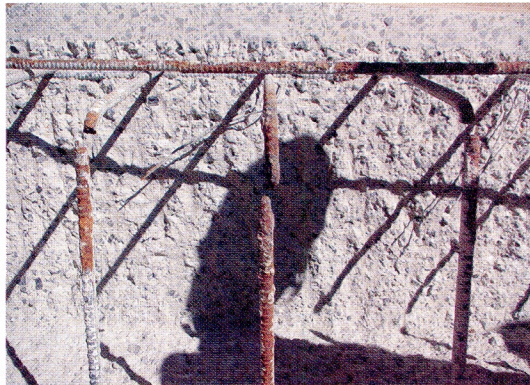
写真-6 腐食を伴う橋台の鉄筋破断 (鉄筋径：D 16 mm, SD 295 A)
