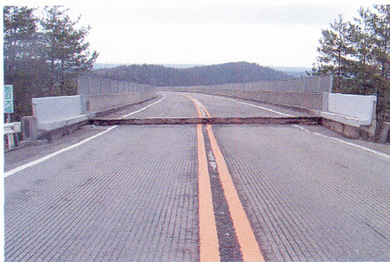
写真-2 ジョイント部の段差
