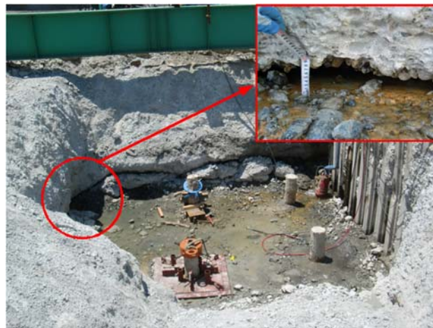
図-13 基礎版下の空洞の様子
