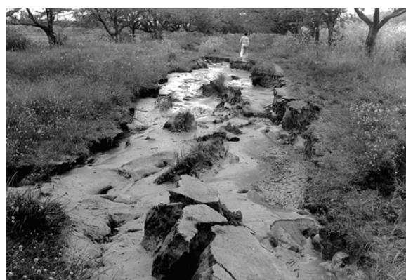
図-9 真野代堤防法尻部の噴砂状況（大河津資料館収蔵写真）
