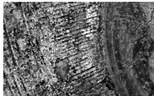
写真4：金属箔が剥落した部分に下地材が確認できる(円光No.30)
