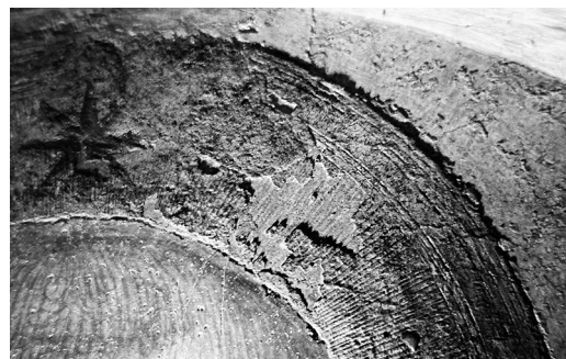
写真3：金属箔が剥落した部分にイントナコが確認できる(円光No.30)
